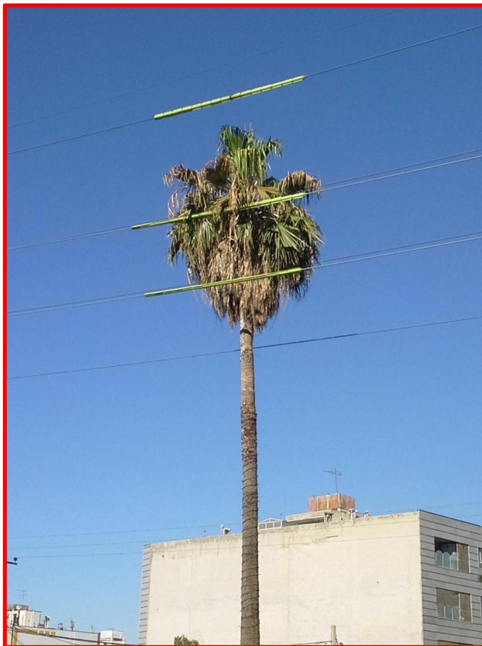
تصویر شماره ۳: روکش عایقی نصب شده بر روی خطوط ۶۶ کیلو ولت استان فارس در حریم درخت
